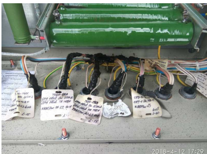
Рисунок 13. Последствия замыкания во вторичных цепях трансформаторов напряжения.
